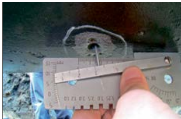
Рис. 3. Дефект на ГО к тепличному комбинату «Южный» DN 530
