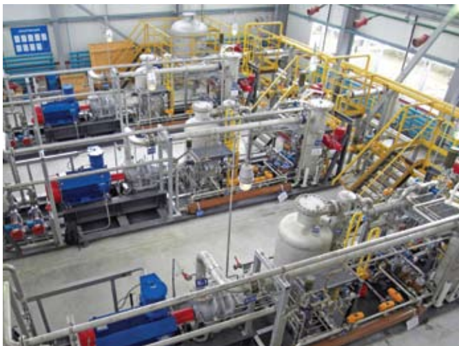
Первый проект по применению ДКУ Enerproject на нефтегазовых месторождениях (ГТЭС Конитлорского м/р)
