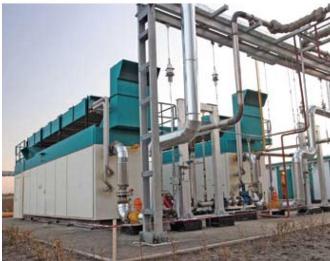
Впервые в России ДКУ Enerproject были установлены на белгородской ГТУ-ТЭЦ «Луч»
