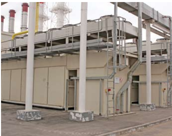
ДКУ Enerproject, предназначенные для эксплуатации в городской черте (ТЭС ММДЦ «Москва-Сити»)
