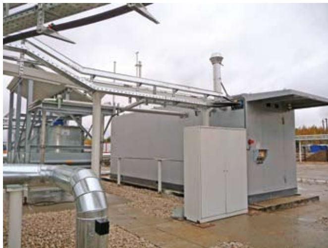
Газодожимная компрессорная установка низкого давления подготавливает ПНГ для ГТЭС Гежского м/р
