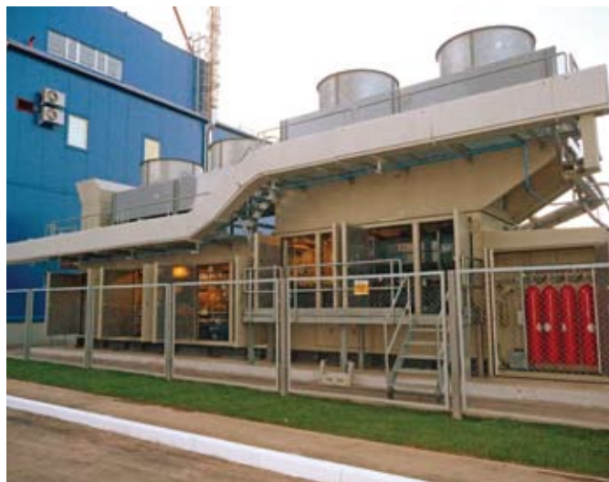
Современная двухступенчатая компрессорная установка обеспечивает топливом ГТУ-30 Калужской ТЭЦ «Квадра»
