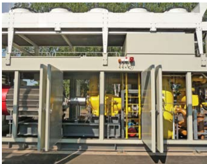
Система подготовки топливного газа от компании «ЭНЕРГАЗ» для турбин парогазовой установки Уфимской ТЭЦ-2
