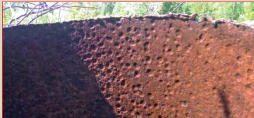
Фото 4. Фрагмент стального газопровода попутного газа в Западной Сибири после аварии с полным разрушением и возгоранием (диаметр 820 мм, толщина стенки 10 мм)
