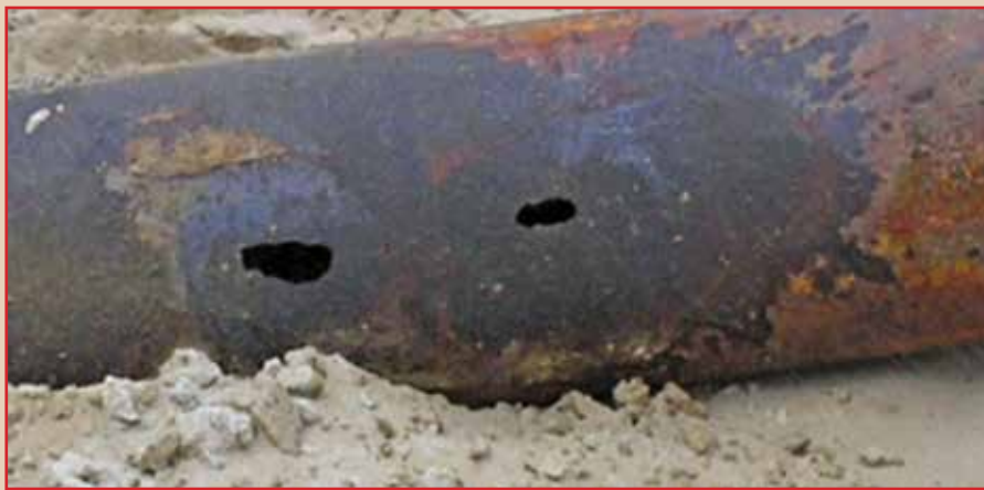
Фото 3. Перфорации НПТ из-за локализованной внутренней коррозии
