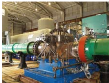
Рис. 1. Магистральный насос типа НМ на испытательном стенде
