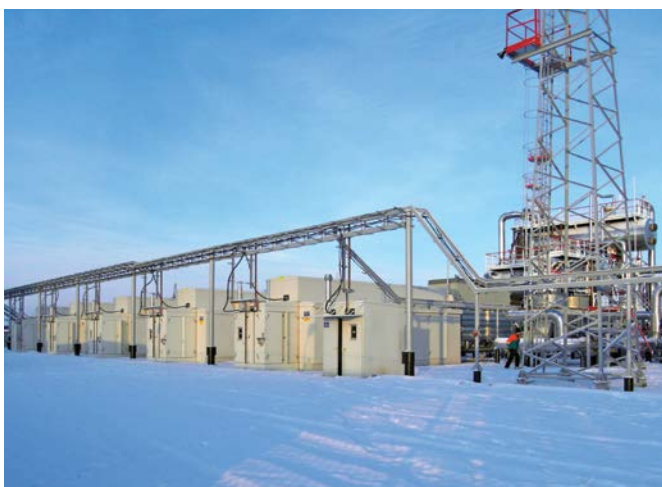
Фото 1. Компрессорные установки Enerproject типа EGSI-S-650/1500WA для компримирования ПНГ
