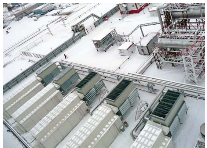
Фото 2. Дожимная компрессорная станция Алехинского нефтяного месторождения в эксплуатации
