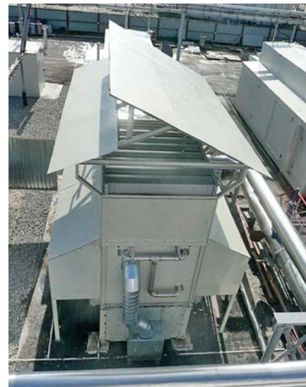
Фото 4. Аппарат воздушного охлаждения после модернизации системы теплообмена ДКУ
