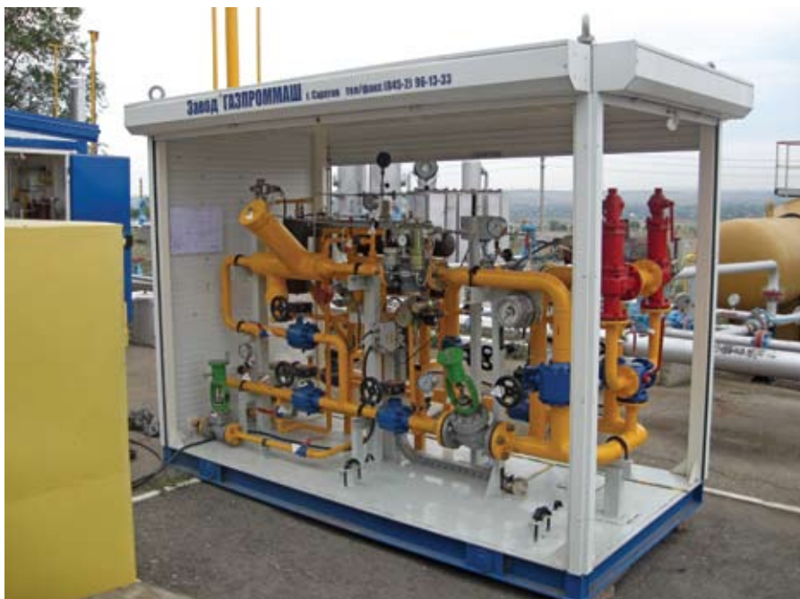
Рис. 2. Мобильный узел подачи газа (МУПГ)
