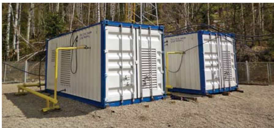
Фото 1. Блочно-модульная станция ТГА на объекте
