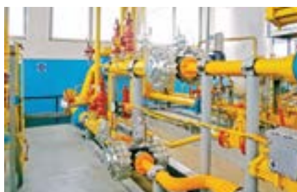
Рис. 3. Регуляторы давления CRONOS CC/080 DN80 ANSI600 RF в составе УППГ «КС-07 Волгоградская» после капитального ремонта (г. Волгоград, ООО «Газпром трансгаз Волгоград», Волгоградское ЛПУ МГ)
