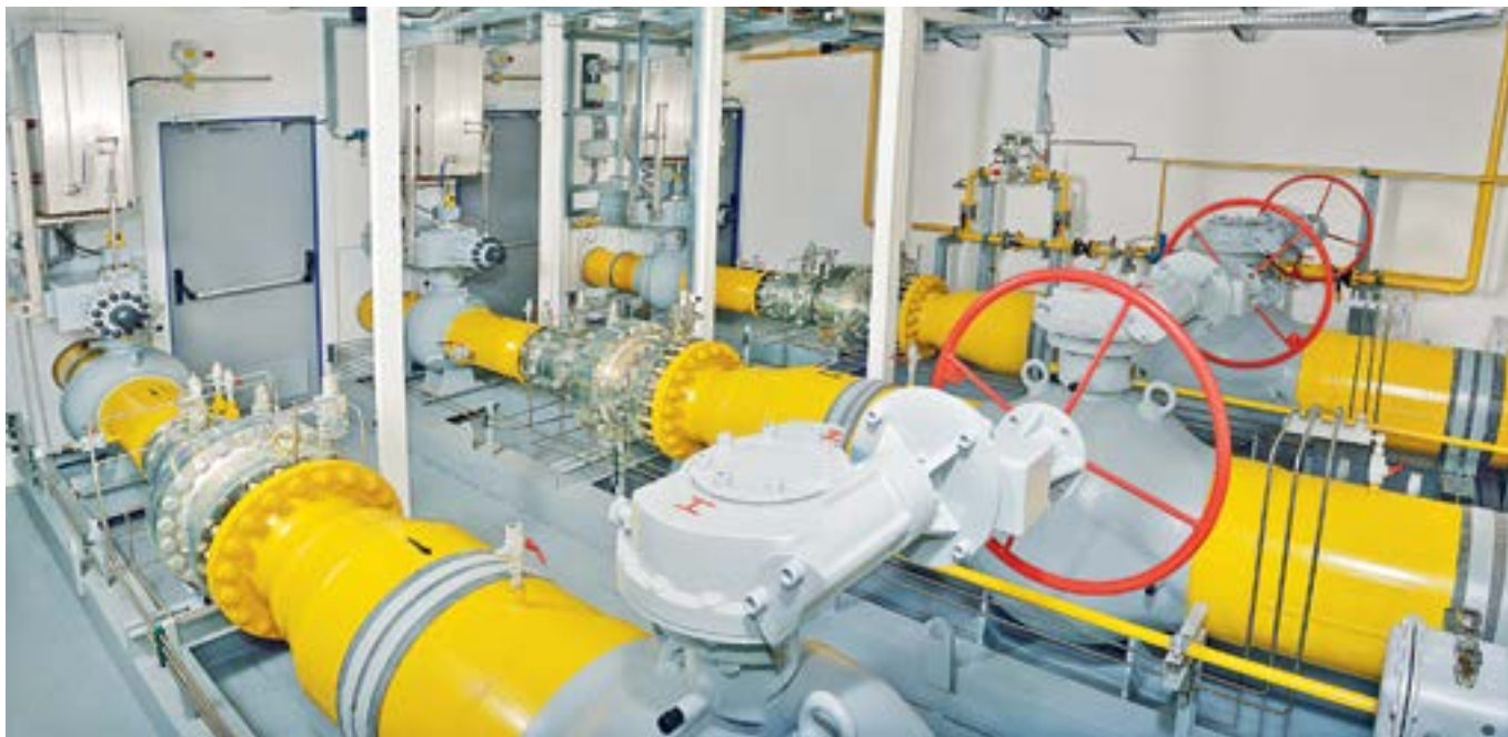
Рис. 2. Регуляторы давления FL/150x300-SRSII DN150xDN300 ANSI600 RF и ПЗК ВМ5/150 DN150 ANSI600 RF в составе ГРС «Камышин» (г. Волгоград, ООО «Газпром трансгаз Волгоград»)
