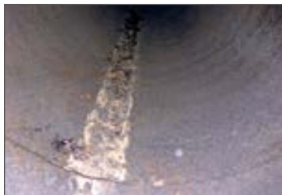
Рис. 2. «Ручейковая» коррозия внутренней поверхности газосборного коллектора куста 213
