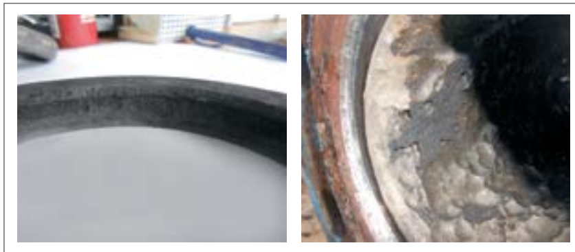
Рис. 1. Разрушения уплотнительного кольца и корпуса струнной задвижки
