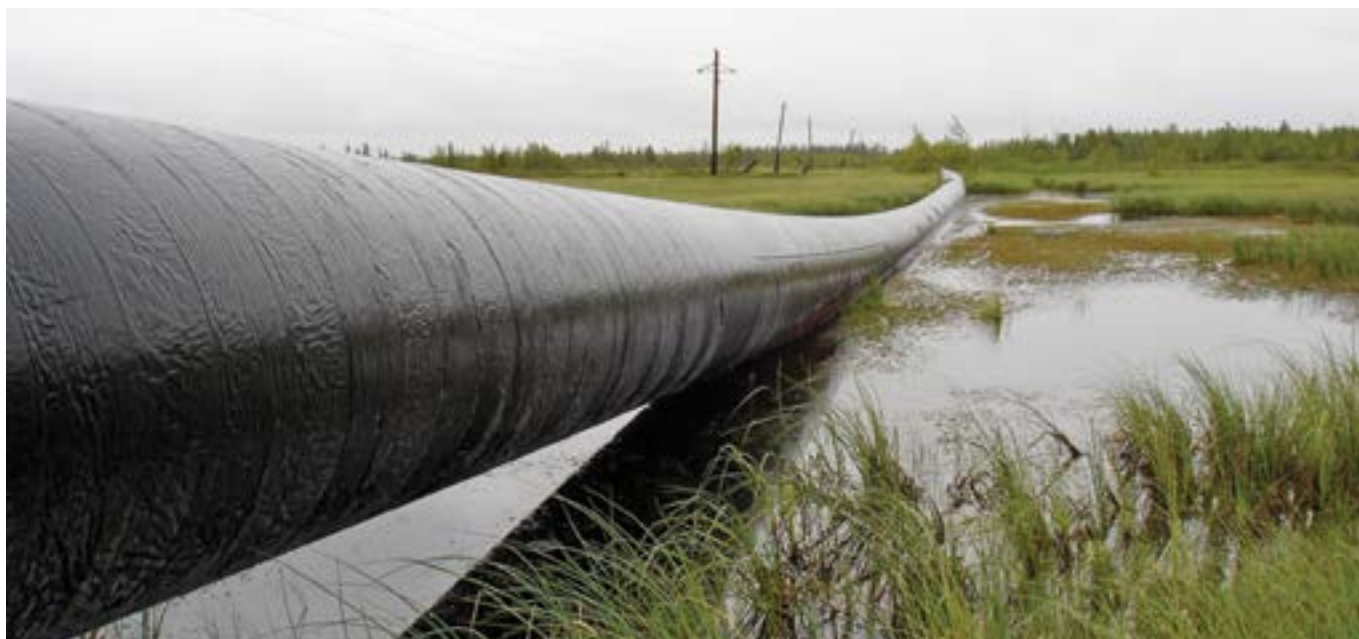
Рис. 2. Всплытие и оголение протяженного участка газопровода «Ямбург – Елец I»
