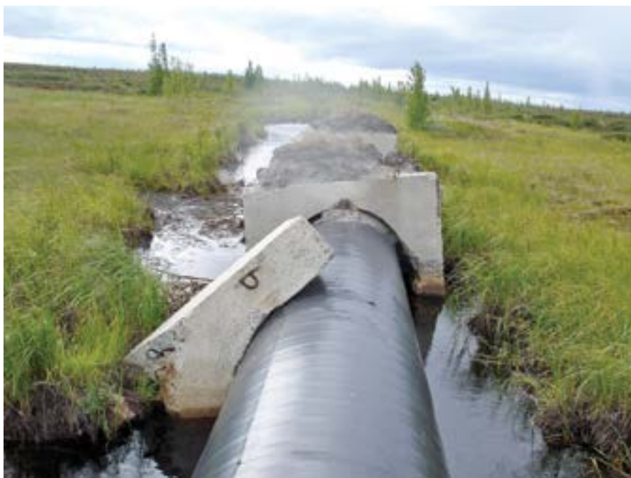
Рис. 1. Всплытие и оголение газопровода «Уренгой – Центр II» с опрокидыванием железобетонных утяжелителей
