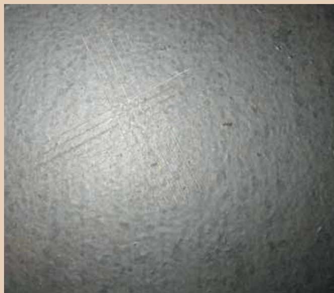
Вид защитного покрытия внутренней поверхности после 11 лет эксплуатации, РВС–50 000 м 3 , «ТНК-Нижневартовск», г. Нижневартовск, 2006 г.
