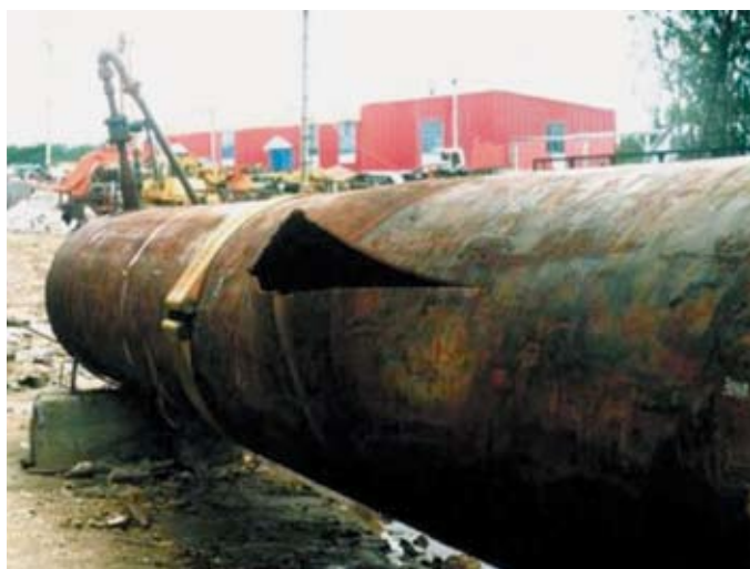
Рисунок 4. Разрушенная труба на полигонных испытаниях муфты РСМ-1220
