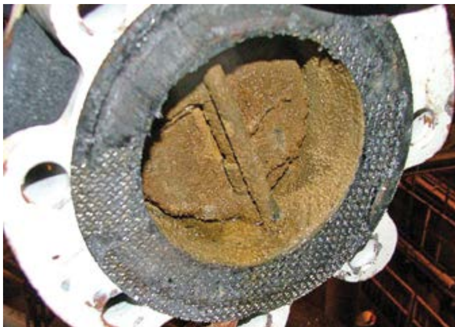
Рис. 3. Солеотложения в клапане трубопровода системы подтоварной воды платформы ПА-Б Fig. 3. Scaling in the pipeline valve of produced water system at PA-B platform
