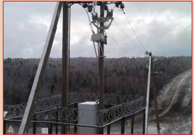
Автоматизация вдольтрассовых линий электроснабжения
