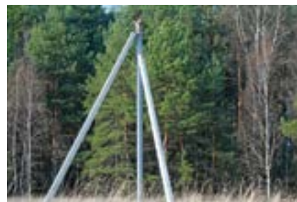
Опора анкерно-угловая в составе линии Северо-Европейского газопровода
