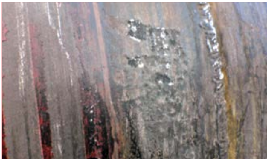
Рис. 1. Коррозионные каверны в околошовном участке кольцевого монтажного стыка МГ «Ухта – Торжок»
