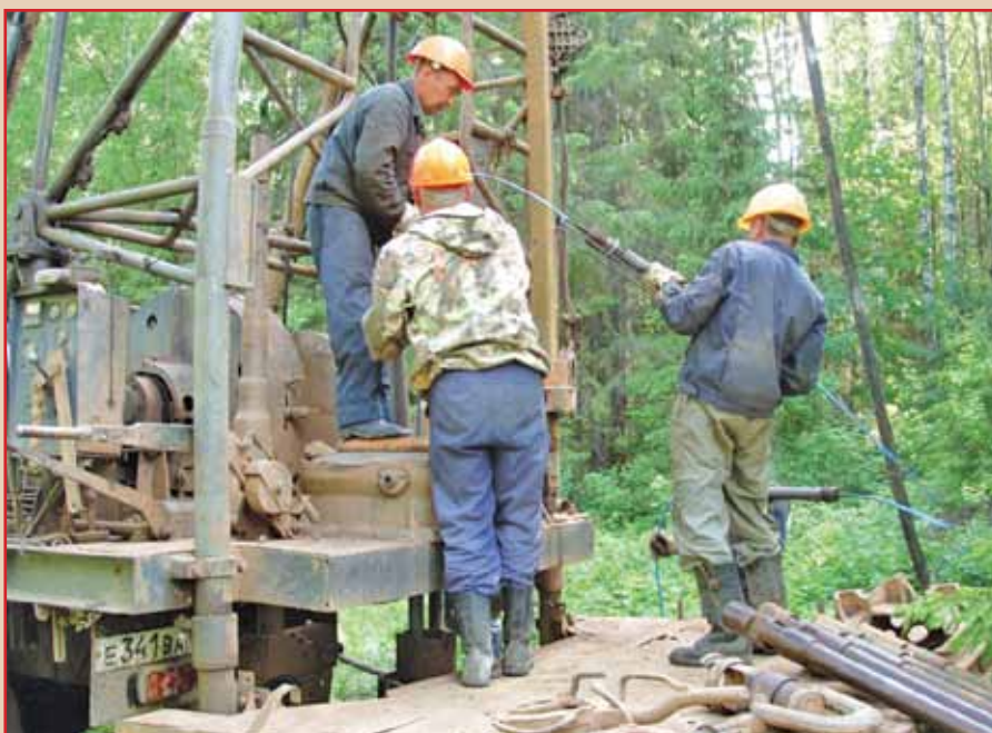
Восстановление отработанного глубинного анодного заземления с применением современного анодного магнетитового заземлителя «Менделеевец-МТ»
