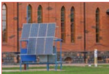
Фото 2. Установка альтернативной энергетики
