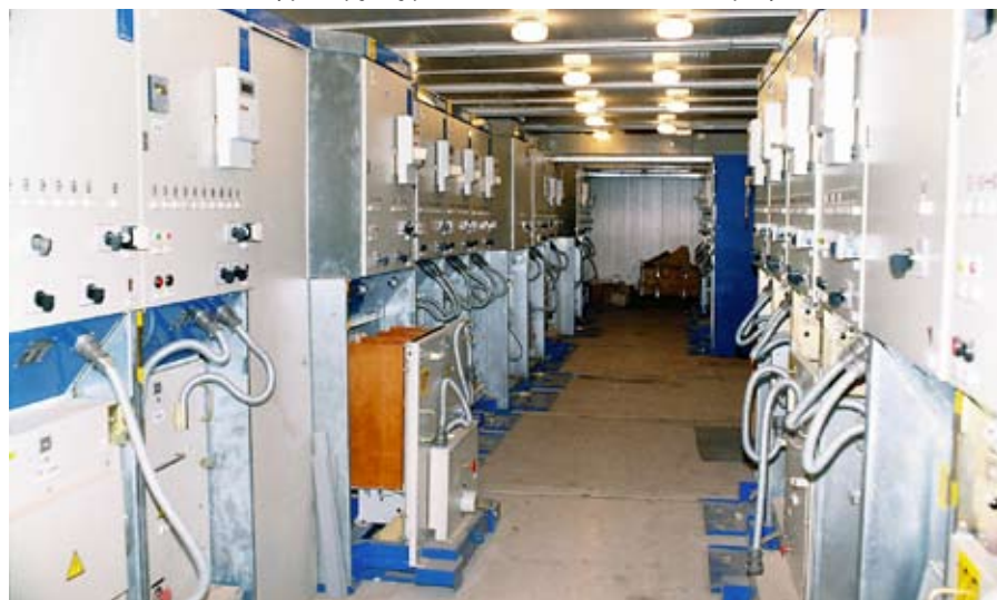
Подстанция 110 кВ «Кавказская», реконструкция которой проведена в 2005 году (г. Оренбург)
