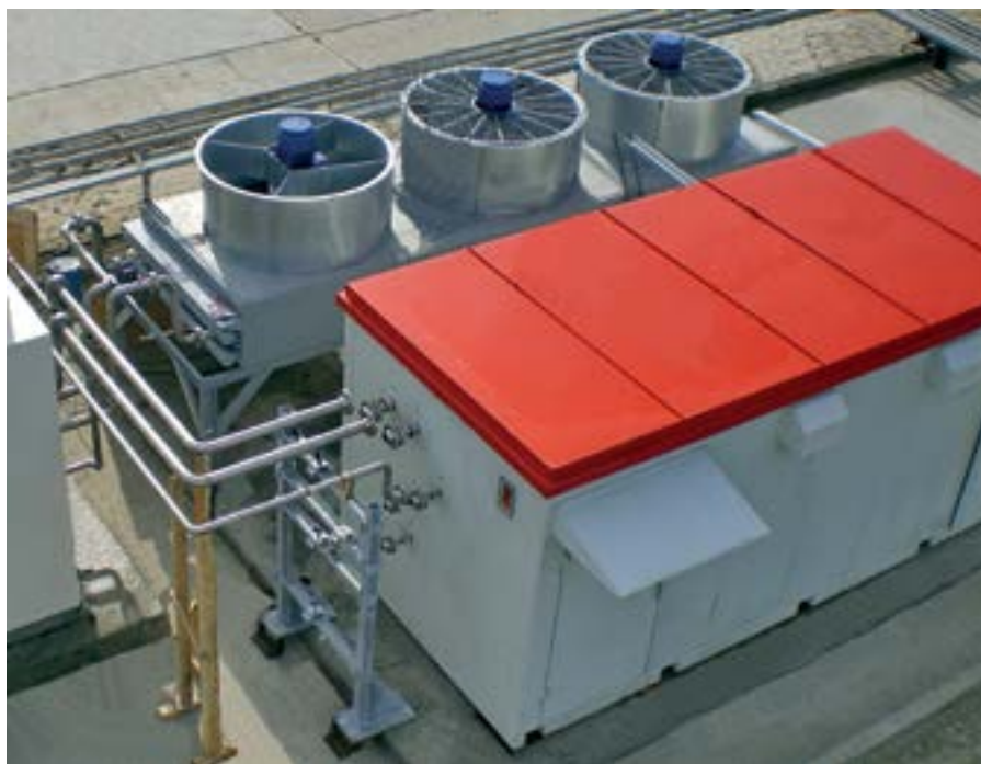
Фото 5. Адсорбционный осушитель газа на ЦПС Западно-Могутлорского месторождения («РуссНефть»)
