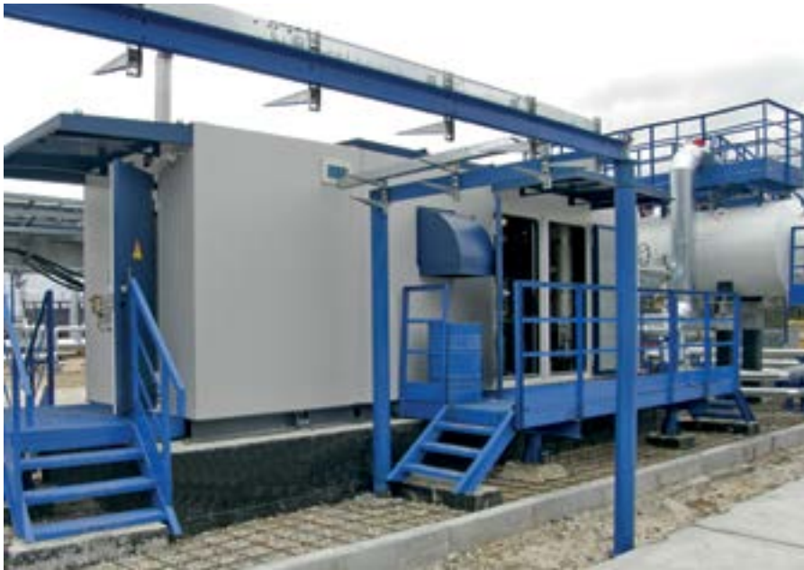
Фото 4. Вакуумная компрессорная установка «ЭНЕРГАЗ» на ДНС-1 Вынгапуровского месторождения («Газпромнефть-ННГ»)
