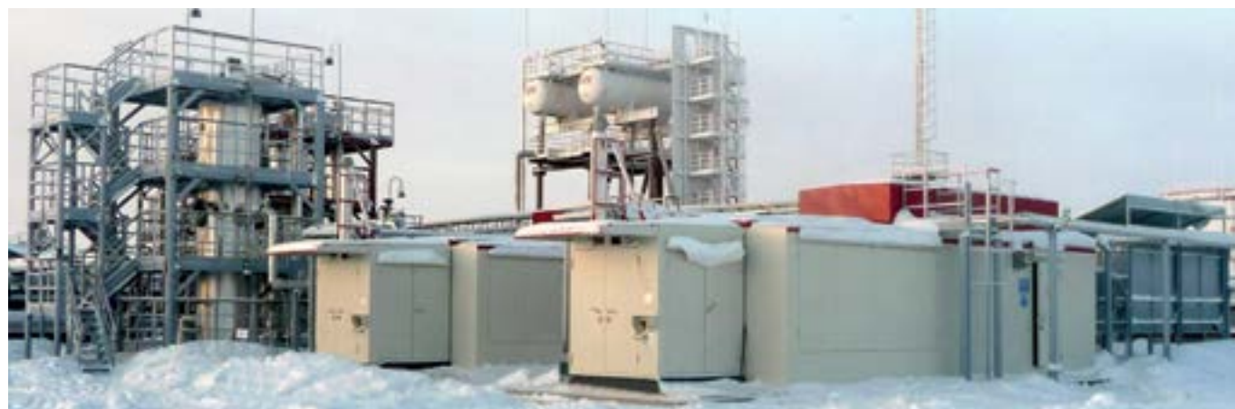
Фото 7. КУ в арктическом исполнении компримируют НН ПНГ в составе СКНС Северо-Лабатьюганского месторождения («Сургутнефтегаз»)
