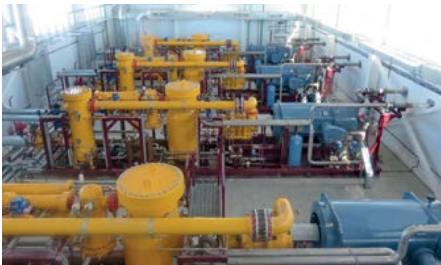
Фото 6. Компрессорная станция внутрицехового типа для ГТЭС Восточно-Мессояхского месторождения
