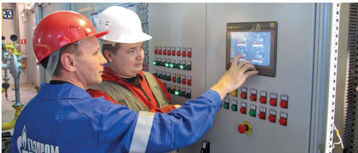
Фото 2. Щит управления котельной КС «Вавожская»
