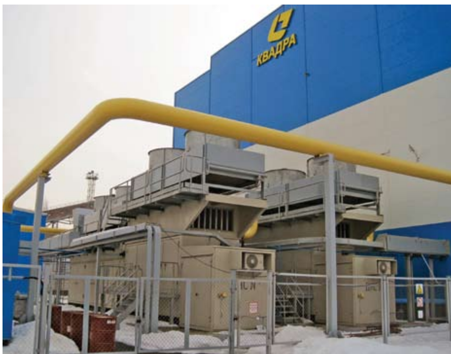
Фото 4. Дожимные компрессорные установки в эксплуатации
