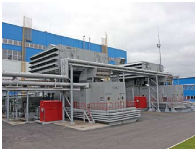
Фото 2. Блочно-модульные газотурбинные установки LM6000PD Sprint производства General Electric
