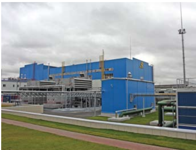
Фото 1. Общий вид ПГУ-115 на Воронежской ТЭЦ-2
