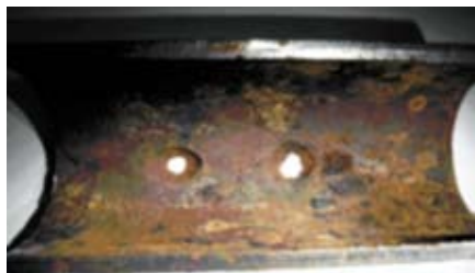
Рис. 4. Образец корродированной НКТ-73 из скв. 1231 Р-С залежи Усинского месторождения через 121 суток работы. Видна сквозная и язвенная коррозия металла труб.
