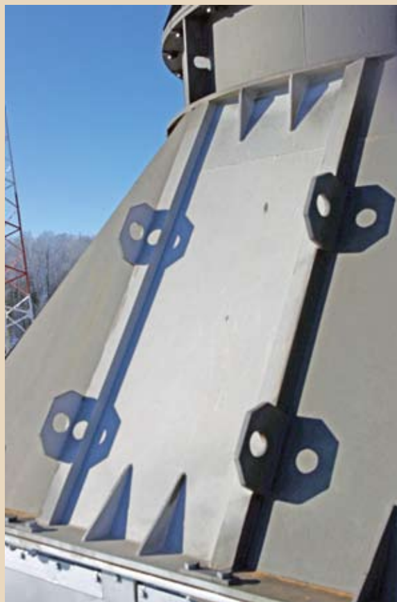
Фото 2. На соседнем покрытии за то же время появились участки коррозии
