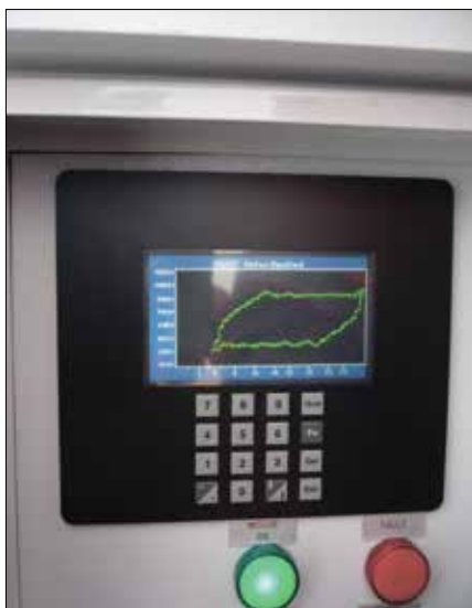
Фото 4. Контроль работы оборудования
