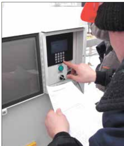
Фото 3. Ввод данных и уставок в контроллер
