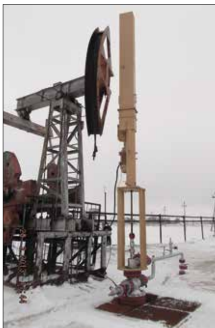
Фото 5. Полностью смонтированный и запущенный в работу LRP
