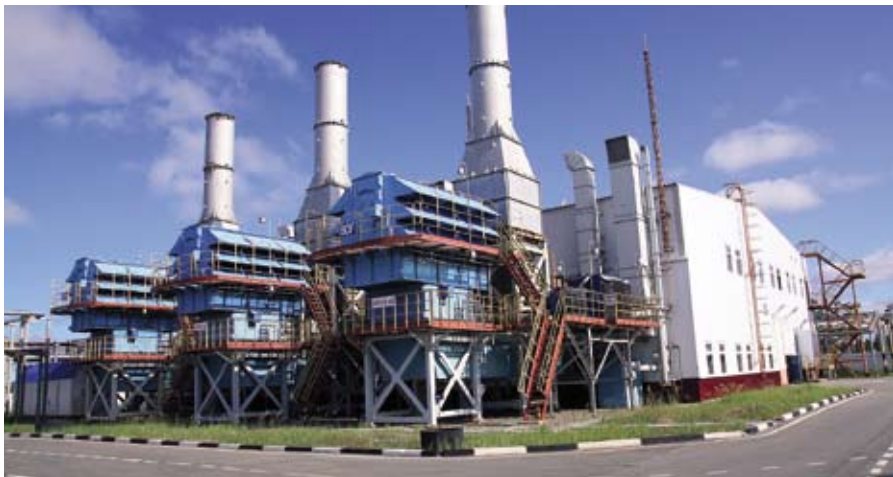
Рис. 3. Газотурбинная электростанция мощностью 36 МВт на Лянторском МНГ, ОАО «Сургутнефтегаз»
