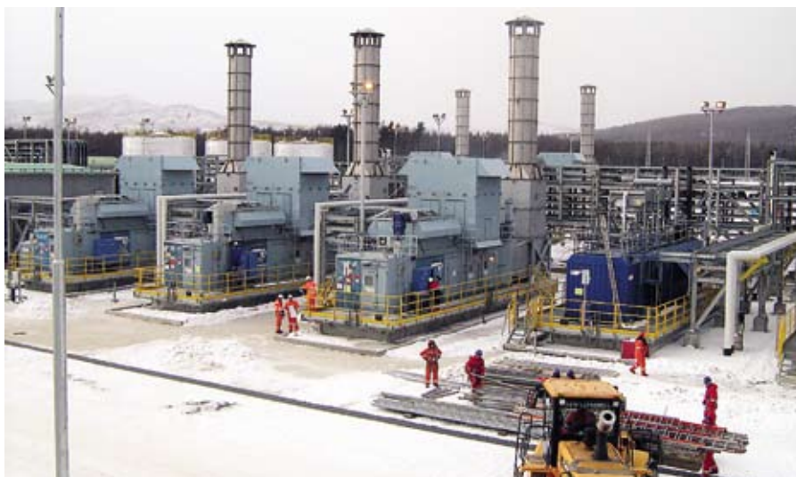
Рис. 1. Газотурбинные электростанции «Урал-4000», о. Сахалин
