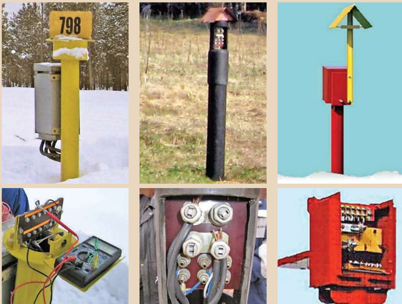
Рис. 3. Примеры конструкции КИП различных типов и их клеммных панелей на магистральных трубопроводах в системах ПКЗ по ГОСТ Р 51164-98
