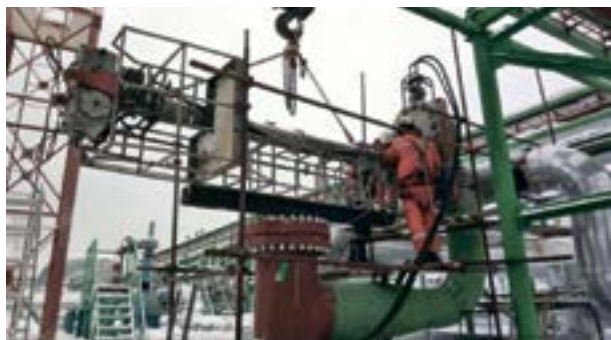
Рис. 1. Горизонтальная врезка для выполнения работ по одностороннему перекрытию для ремонта дефектного участка трубопровода Ду 700 мм
