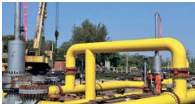
Рис. 2. Двустороннее перекрытие с применением двух фитингов и временной байпасной линии для осуществления работ на отсечном участке действующего трубопровода Ду 500 мм
