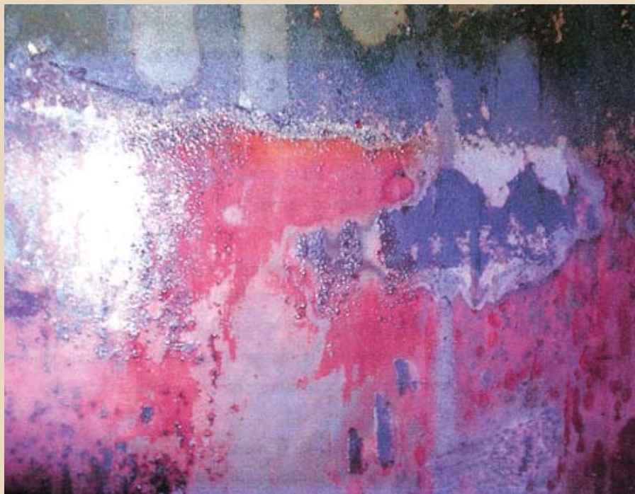
Рис. 3 – Фрагмент внутренней поверхности абсорбера с дополнительным полиуретановым покрытием после 4 месяцев эксплуатации
