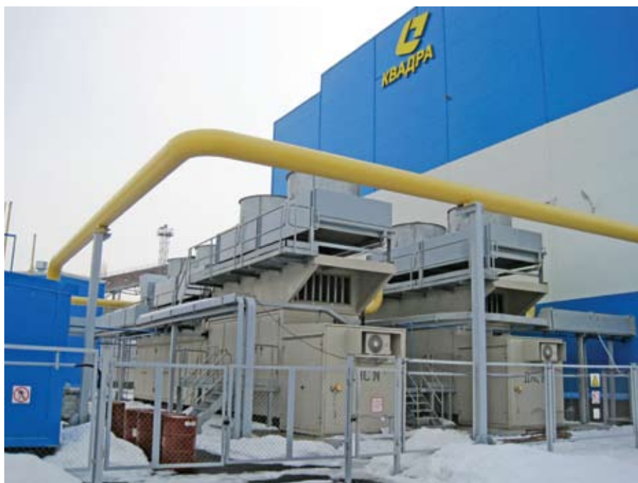
Фото 1. Блочно-модульная система газоподготовки «ЭНЕРГАЗ-Enerproject» на ПГУ-115 Воронежской ТЭЦ «Квадра»
