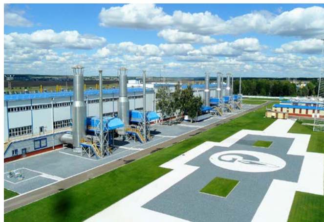
Фото 9. Компрессорная станция Полянского ЛПУМГ
