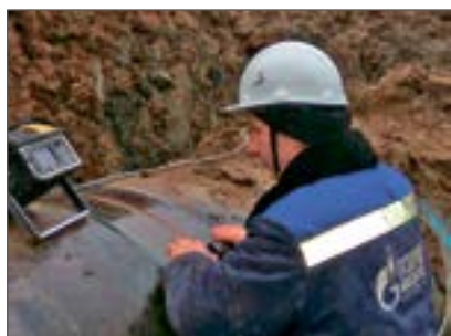
Рис. 4. Контроль эксплуатационного сварного соединения со смещением, труба DN 1420
