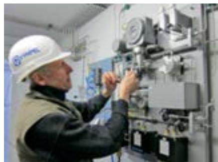
Рис. 1. Анализатор «Конг-Прима-10» на газопроводе «Северный поток» (Германия)
