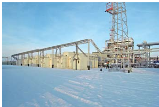
Фото 1. Компрессорная станция Enerproject на Алейкинском месторождении (ОАО «Сургутнефтегаз»)
