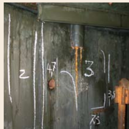
Рис. 2. Повреждения металла, абсорбер ЗУ272С01 (2007 год).
