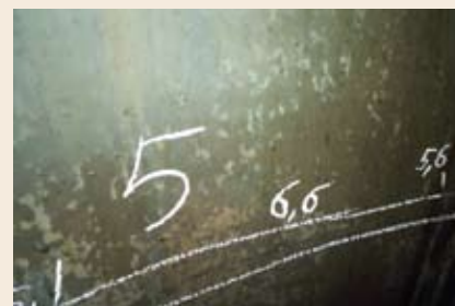
Рис. 4. Повреждения металла, абсорбер ЗУ272С01 (2007 год).
