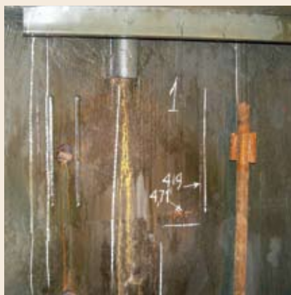
Рис. 1. Повреждения металла, абсорбер ЗУ272С01 (2006 год).
