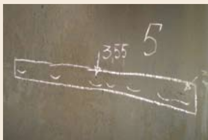
Рис. 3. Повреждения металла, абсорбер ЗУ272С01 (2006 год).
