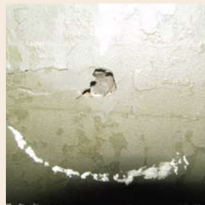
Рис. 5. Повреждения металла внутри дефекта покрытия («пробой»).
