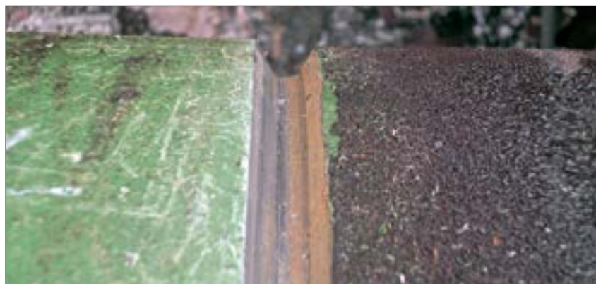
Участок трубопровода с выбранным дефектом в сварном шве
