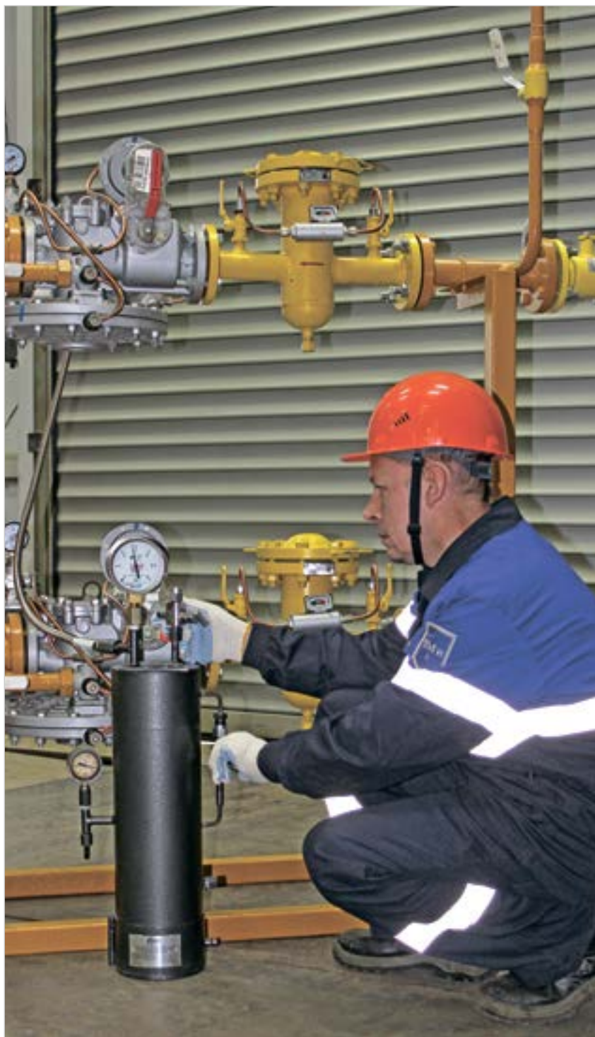
Фото 2. Подключение УдНК к техническому устройству пункта редуцирования газа
