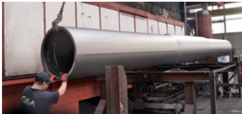
Рис. 5. Гаситель лавинного смятия на газопроводе Fig. 5. Buckle arrester on the gas pipeline
