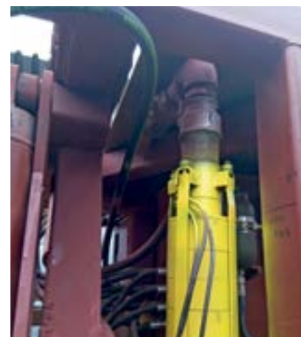
Рис. 3. Водяной насос на погружном блоке Fig. 3. Submersible unit water pump
