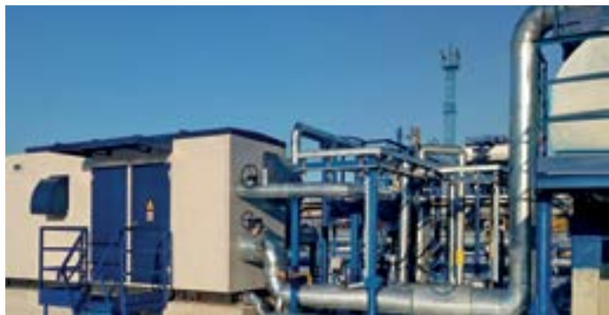
Фото 1. Система подготовки ПНГ низких ступеней сепарации на Вынгапуровском месторождении
