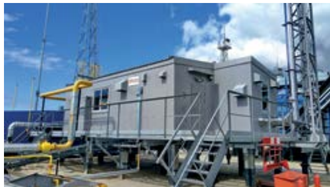
Фото 9. Установка подготовки ПНГ для энергокомплекса Барсуковского месторождения
