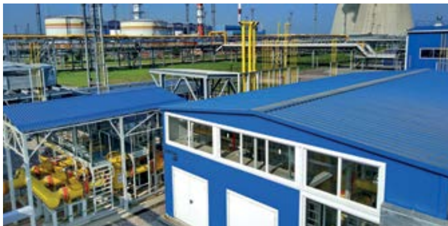
Фото 5. Многоблочный ППГ в составе системы комплексной газоподготовки Прегольской ТЭС
