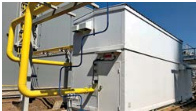
Фото 3. Блочный пункт очистки газа входит в состав системы газоподготовки для ГТУ-ТЭС в Елабуге
