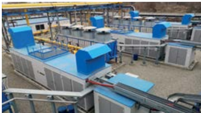
Фото 8. Дожимная компрессорная станция обеспечивает топливным газом турбины Грозненской ТЭС
