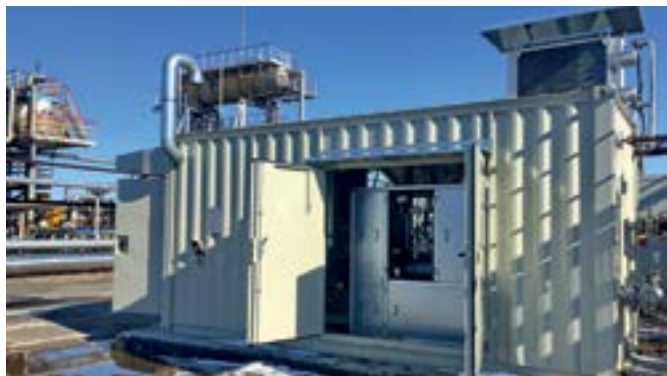
Фото 6. Малая газокompрессорная установка на площадке ДНС-2 Конитлорского месторождения
