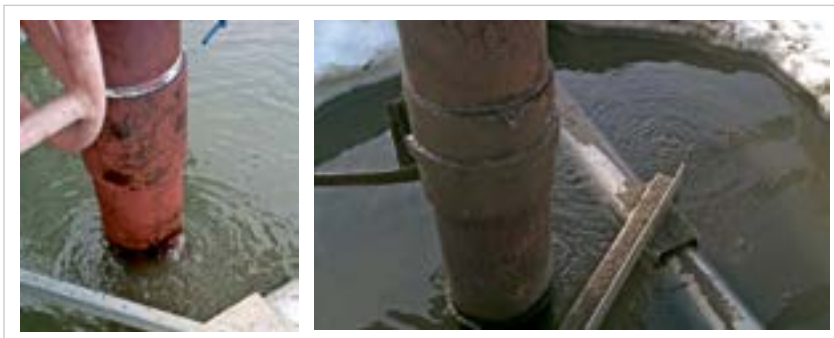
Рис. 1. Заколонные газопроявления (грифоны) около эксплуатационных газовых скважин ЯНГКМ (фото Н.Р. Аветова)
