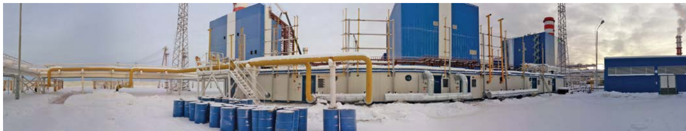
Рис. 2. Пункт подготовки газа производства ОАО «БЗМТО» для Няганской ГРЭС (производительность – 250 тыс. м 3 /ч)
