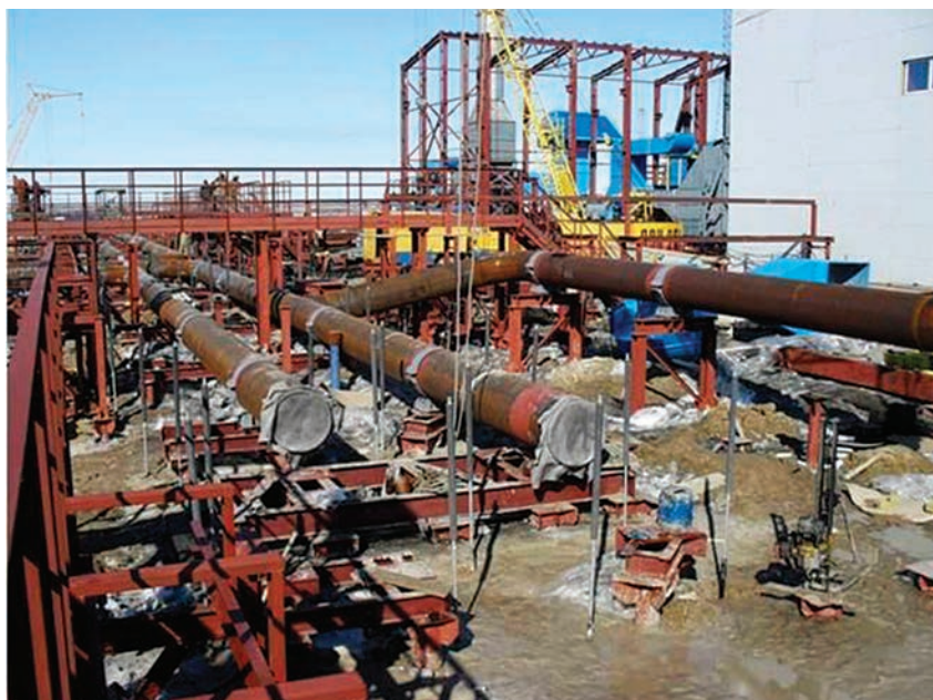
Рис. 4. Вид обвязки ГПА 1 ДКС 5В Уренгойского месторождения, июль 2010 г.
