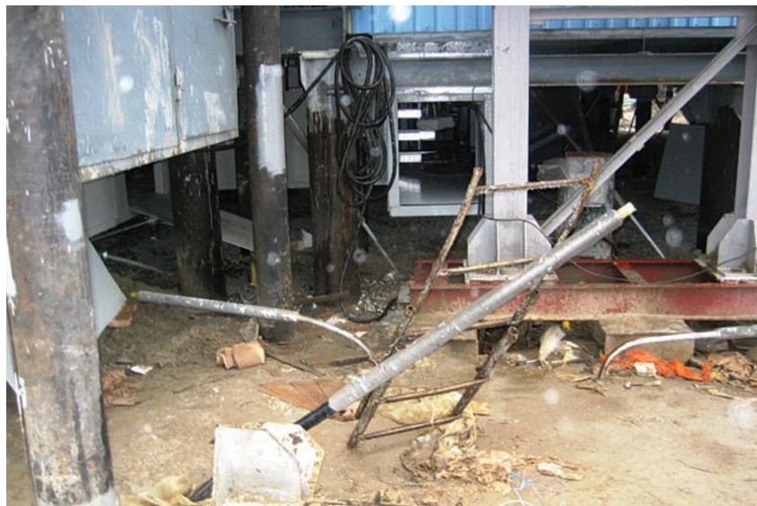
Рис. 6. Деформированные и вышедшие из строя термостабилизаторы на ГКС Заполярного месторождения, сентябрь 2012 г.
