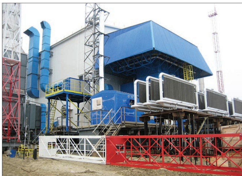
Рис. 5. Конденсаторные блоки систем «ВЕТ» на ГКС Заполярного месторождения, сентябрь 2012 г.
