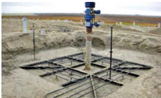
Рис. 3. Система температурной стабилизации грунтов «ВЕТ» на опорной раме
