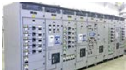
Рис. 8. Низковольтное комплектное устройство серии «Альбатрос» Fig. 8. Low-voltage complete device of the Albatross series
