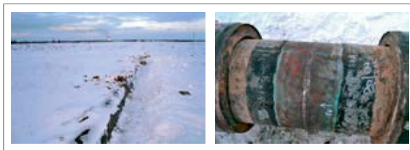
Рис. 1. Участок нефтепровода с повышенной нескомпенсированной деформацией: а) внешний вид участка; б) монтажный сварной шов в зоне его вскрытия
