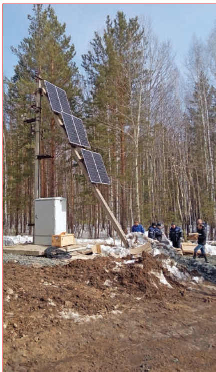
Фото 3. Станция катодной защиты с автономным источником питания
