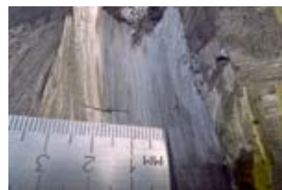
Глубина 15 мм, длина трещины 15 мм
