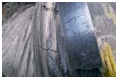
Рис. 5. Трещина выходит на торцевую кромку трубы
