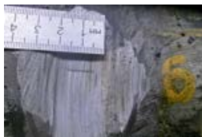
Глубина 6 мм, длина трещины 10 мм
