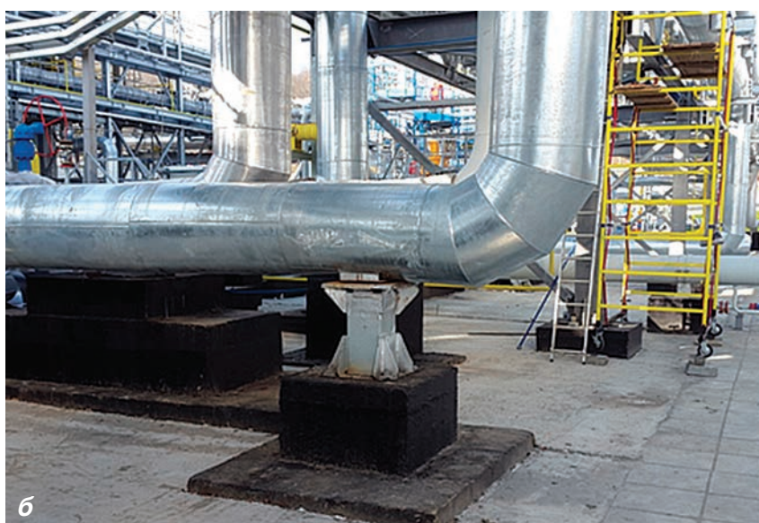
Рис. 4. Опорно-подвесная система коллекторов УПГТ-2 КС «Краснодарская»
