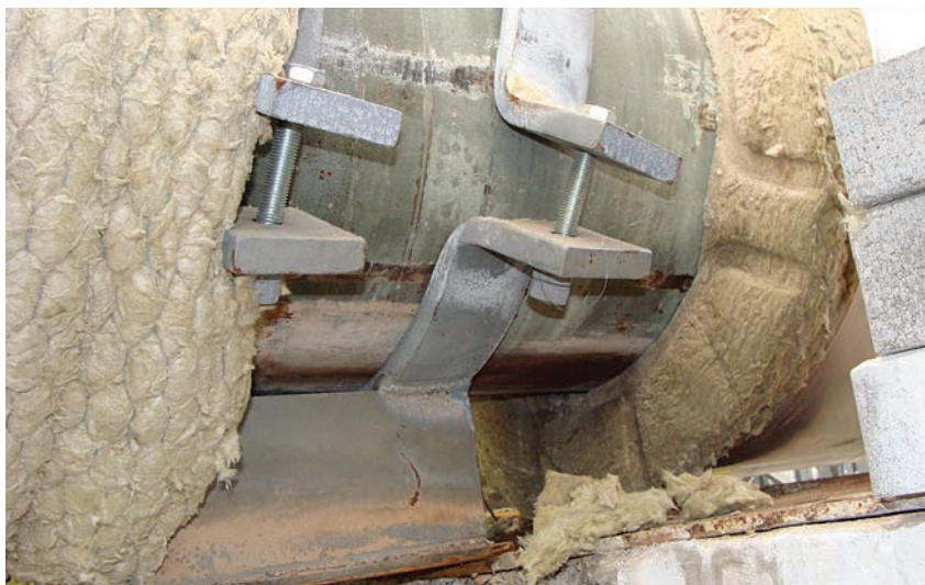
Рис. 2. Смещение скользящей хомутовой опоры с бетонного основания в процессе эксплуатации УПГТ
