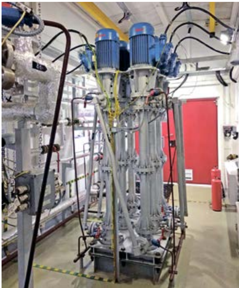
Рис. 1. Насос НЦСГЕ-0,5-3000-Д-УХЛ2 в работе
